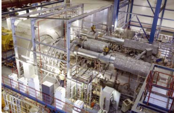
Turbina a gás de ciclo combinado do tipo das que estão a ser instaladas na Central do Pego em Abrantes (cortesia da Siemens).
