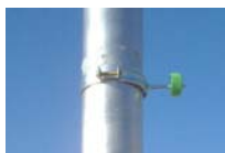
Fig. 4. Braçadeira com tampa colocada num candeeiro.
